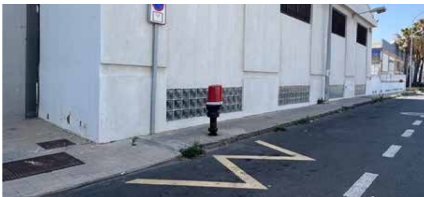
Hidrante señalado con prohibición de estacionamiento.
