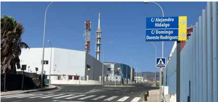
Tendido aéreo de telecomunicaciones visible sobre fachadas y postes.
