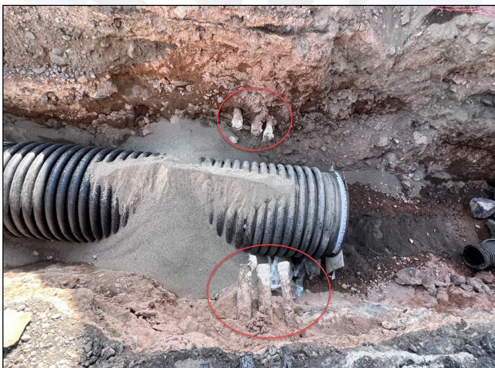
Fig. 10- Conducciones de combustible cortadas, pudiendo apreciarse la interferencia que realizaban con el tendido de la nueva conducción.
